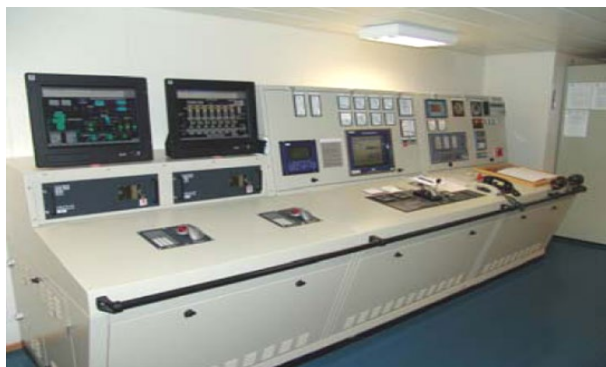
Slika 3.83. Glavni upravljački panel u upravljačkoj kabini strojarnice (engl. Main Operating Panel - MOP) , [2]
