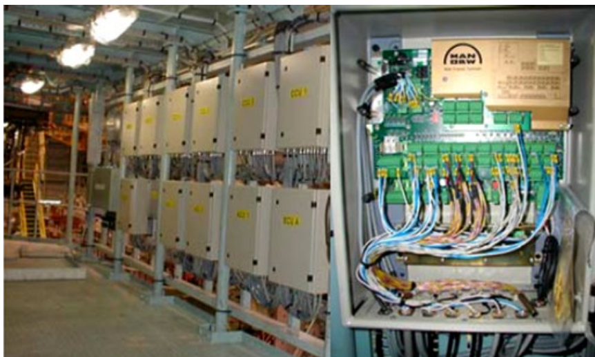
Slika 3.82. Panel s upravljačkim jedinicama 6S70ME-C motora i pogled unutar jedne od njih, [2]
